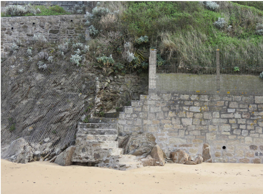
Escalier d'accès à la plage du Minihic depuis la parcelle cadastrée K 92
